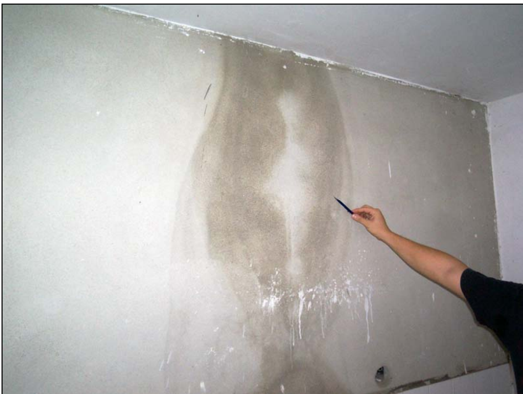
FOTO 11 - Infiltração na parede pilar
