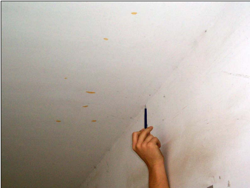
FOTO 10 - Laje com ferragem oxidada
