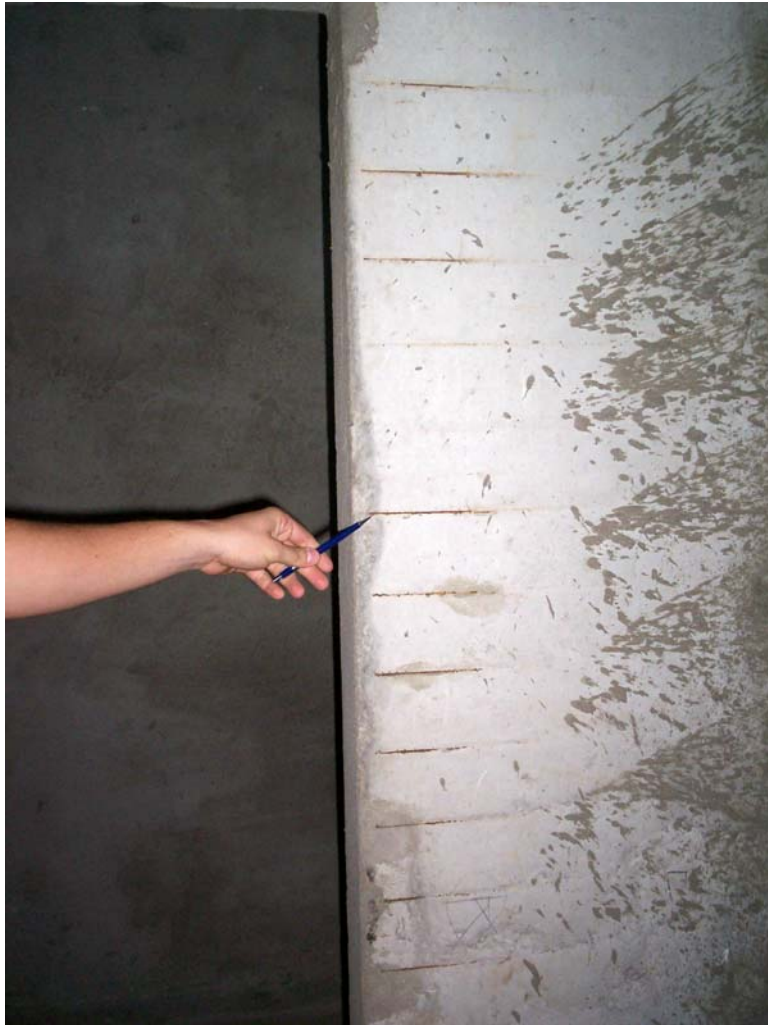
FOTO 9 - Ferragem exposta e oxidada na parede pilar
