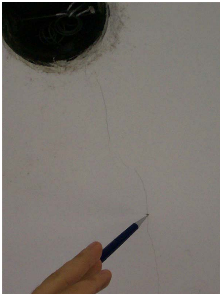
FOTO 8 - Fissura na laje por causa de conduite
