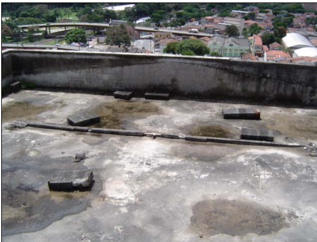
FOTO 12 – Infiltração em laje de cobertura
